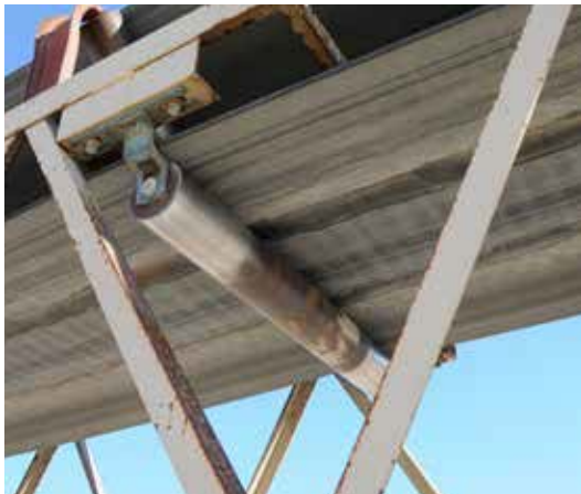
ANTES: DAÑO EN LA BANDA/SOPORTE
